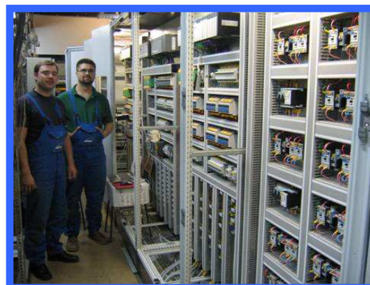
PWiK – wodociągi Głogów
