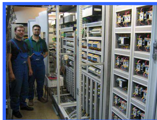
PWiK – wodociągi Głogów
